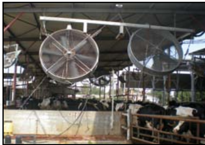
Ventilatori inclinati che assicurano comfort ai capi e contribuiscono ad avere quella fermentazione aerobica necessaria a mantenere asciutte le lettiere.
